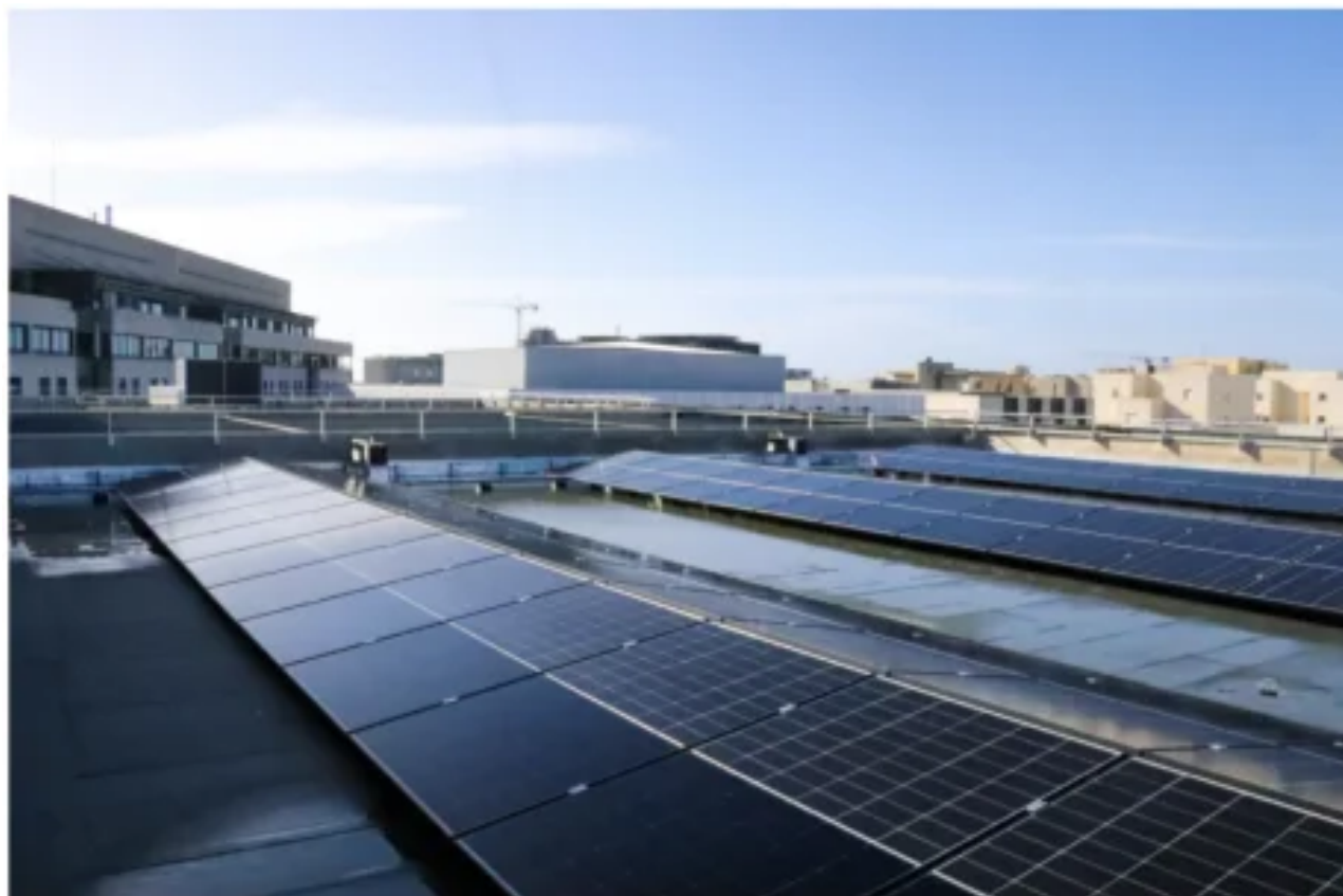
La centrale photovoltaïque de l'Université de Montpellier - © Université de Montpellier
